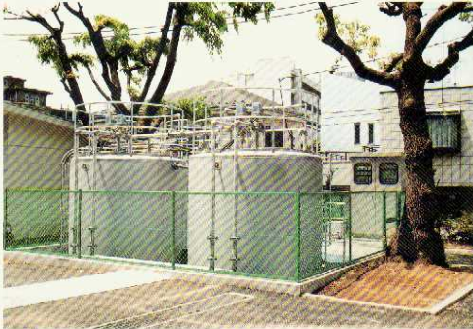
慶應義塾大学医学部R1排水設備
